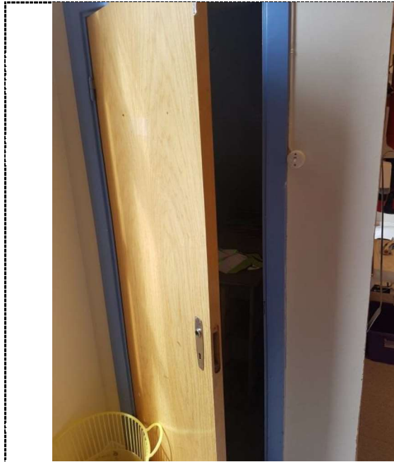
Bilde viser uklassifisert og defekt dør inn til lager/kott i rømningsvei under det ene trappeløpet på skolen.
