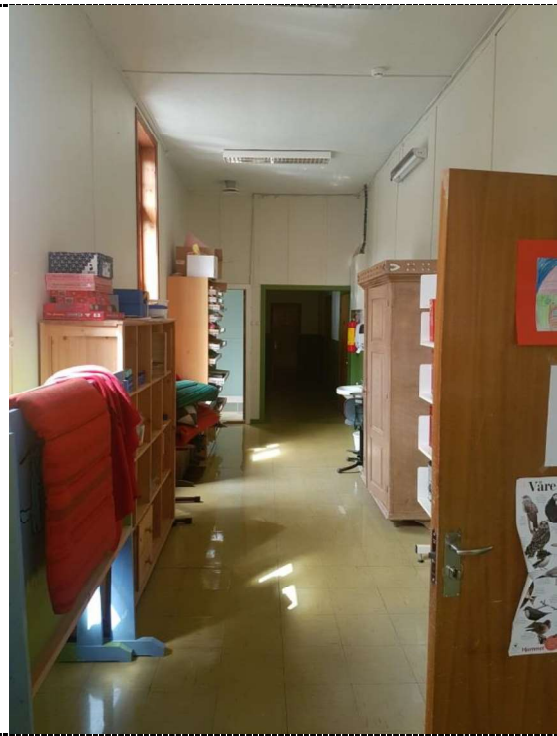
Bilde viser eksempel på lagring i rømningskorridor på skolen og manglende merking av rømningsvei.
