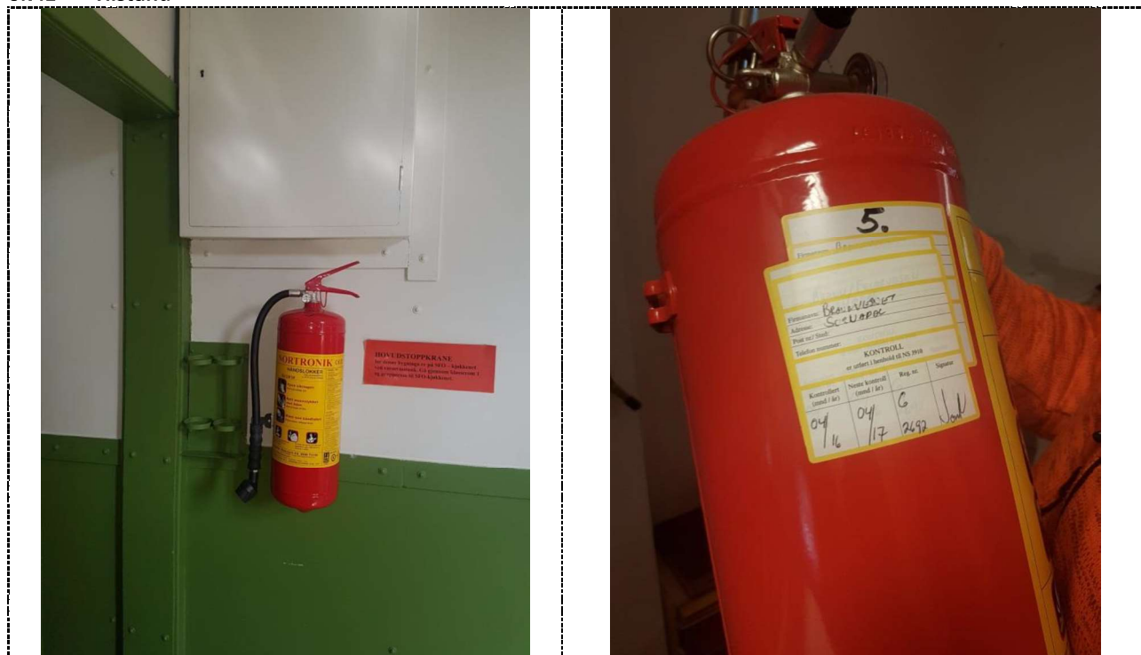
Bilde viser håndslukker i 2.etg. på skolen og i barnehagen som mangler tilstrekkelig merking og kontroll.
