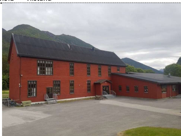
Bilde viser skolens fasade hvor hovedbæring er av brennbare materialer
