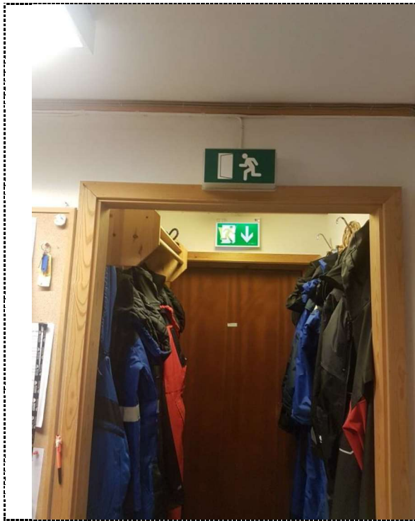
Bilde viser en av rømningsveiene fra barnehagen som er delvis blokkert av klær. Bilde viser også elektrisk utgangsmarkeringsskilt som er defekt.
